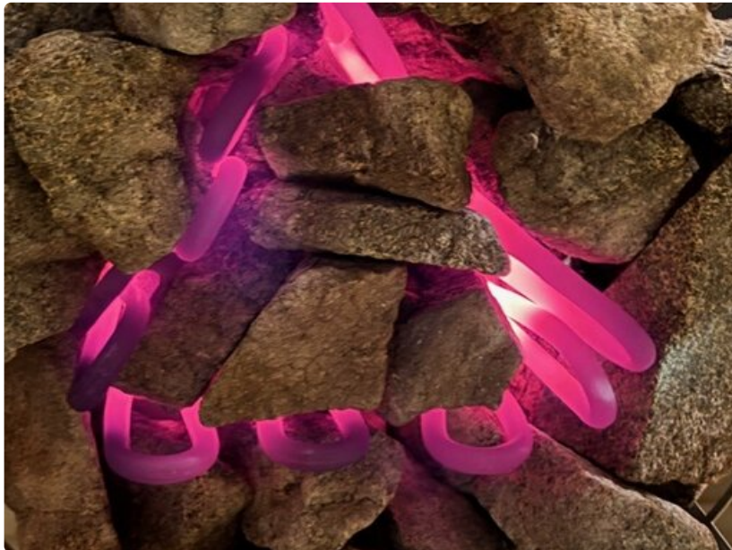
Vastuksen valkohehku kertoo siitä, että vastuksen lämpötila on yli 1000 aastetta. Tässä vaiheessa kiukaan vieressä olevat paneelit olivat niin kuumia, ettei niihin voinut koskea.
