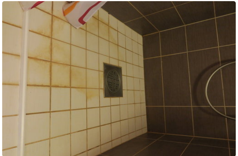
Pesuhuoneen lattia on jäänyt useammankin kerran puhdistamatta. Perusongelmana tosin on se, että lattian valiuuvaiheessa lattiakaivon viereen on jäänyt painauma, johon suihkuvesi jää makaamaan.
