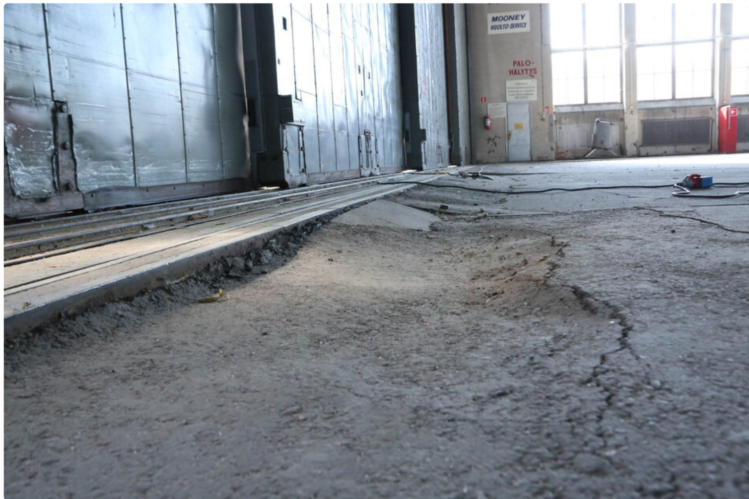
Malmin hallin romahtanut lattia. Lähde: www.malmiairport.fi
