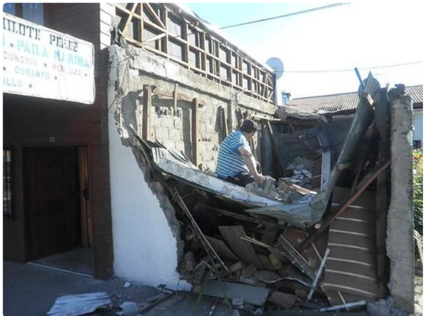
Tuhoa maanjäristyksen jälkeen Villarricassa.
