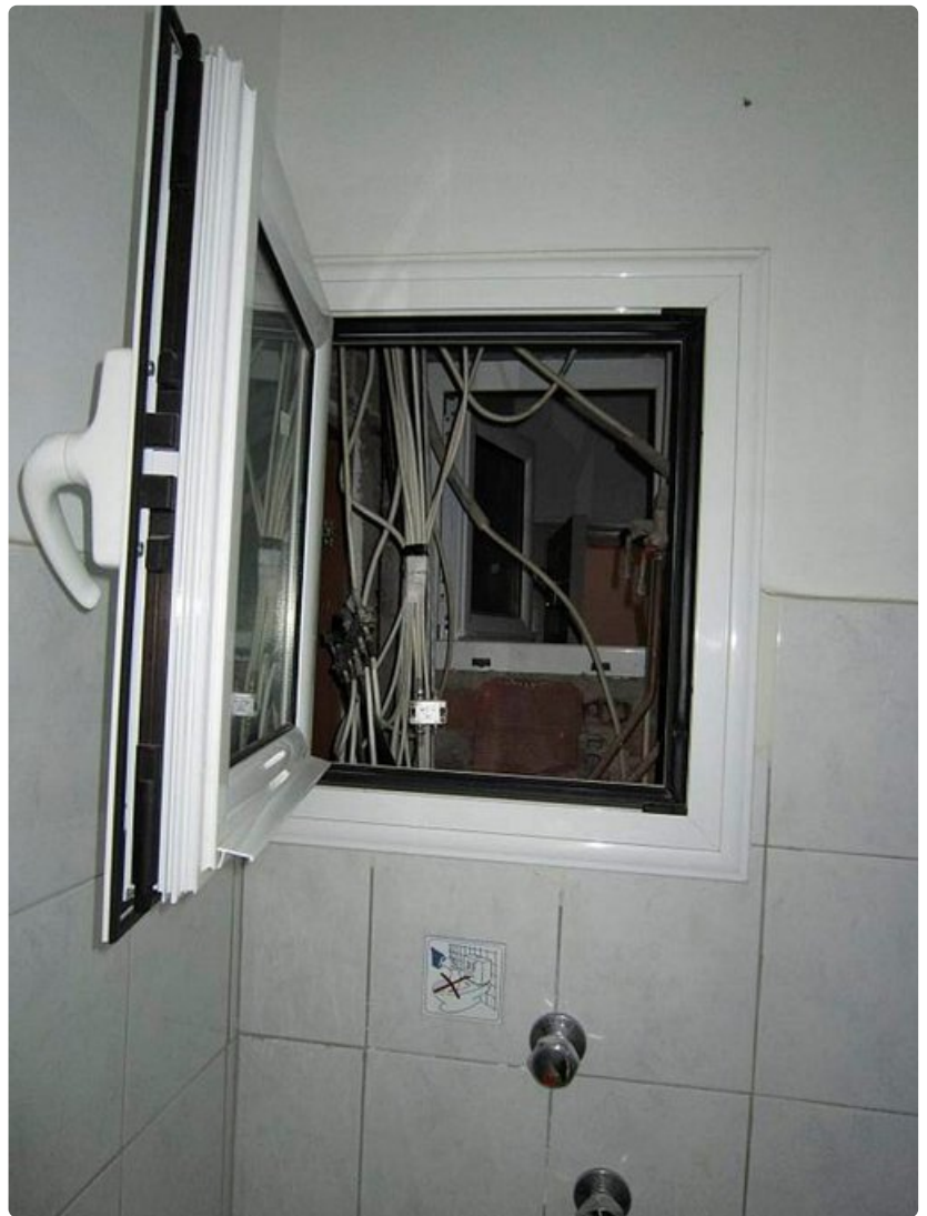
Hotellin kylpyhuoneen tuuletusikkunan kautta paljastui kaapelikoulu ja naapurihuoneen vessan ikkuna.
