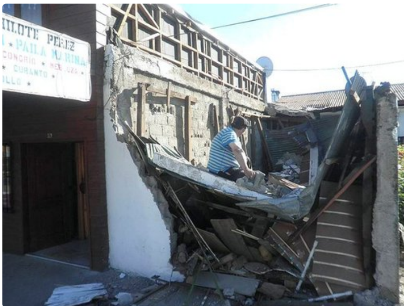
Tuhoja maanjäristyksen jälkeen Villarricassa.
